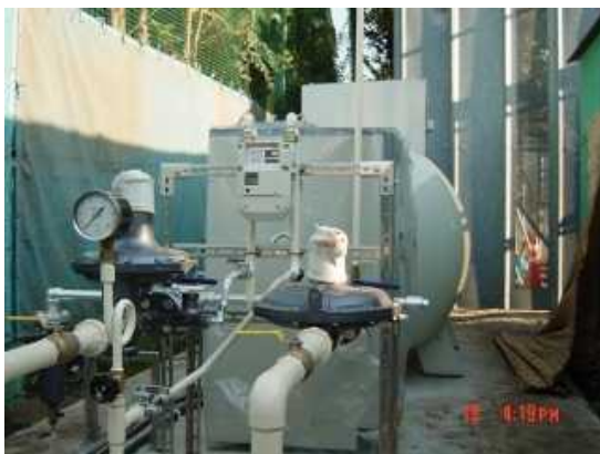
校庭に設置されたバルクタンク
