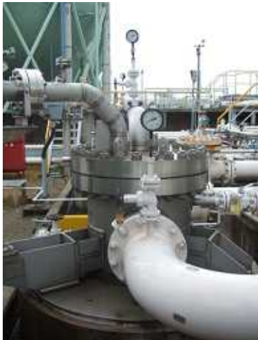
L P G ポンプの耐震化
