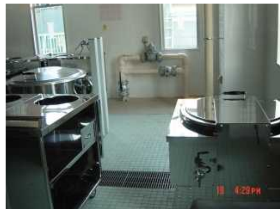
給食室内の様子(中央奥がLPガス配管)
