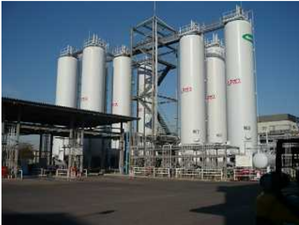
L P ガス貯槽群
