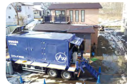
室蘭・登別の大規模停電に移動式電源車が出動し、介護施設等建物2カ所に電気を供給しているところ (出典:月刊クオリティ)
