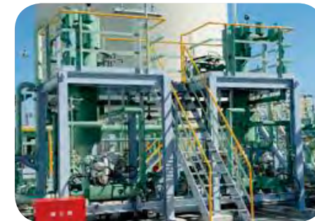
熱量調整装置(出典:九州ガス圧送(株))
