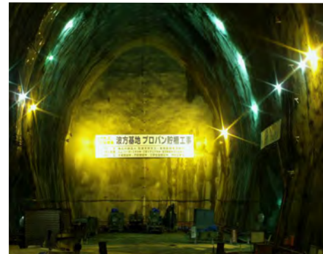
波方基地 岩盤貯槽 Namikata Base Rock Cavern Tank
