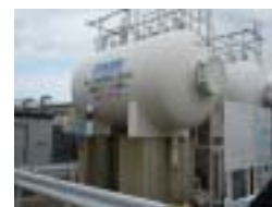
DMEトラックに DME 燃料を給油する充填所
