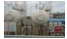
DME 貯蔵タンク
