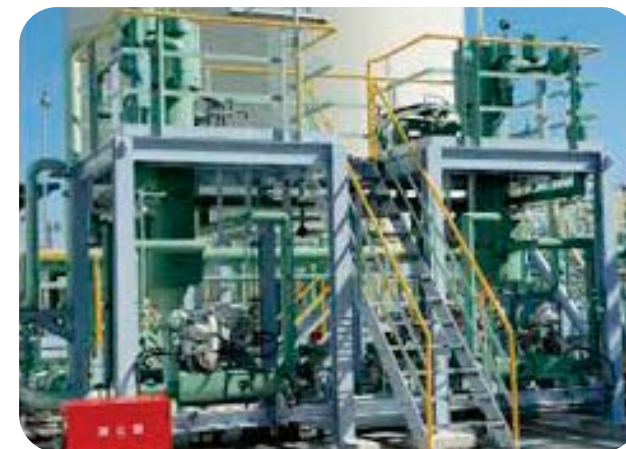
熱量調整装置(出典:九州ガス圧送 株)
