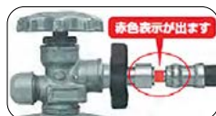
ガスを遮断している状態
