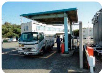
LP自動車充填設備
