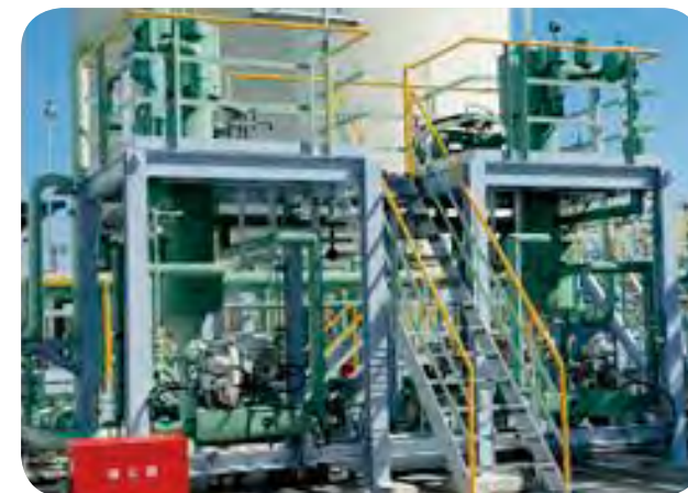
熱量調整装置(出典:九州ガス圧送 株)
