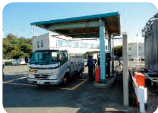
LP自動車充填設備
