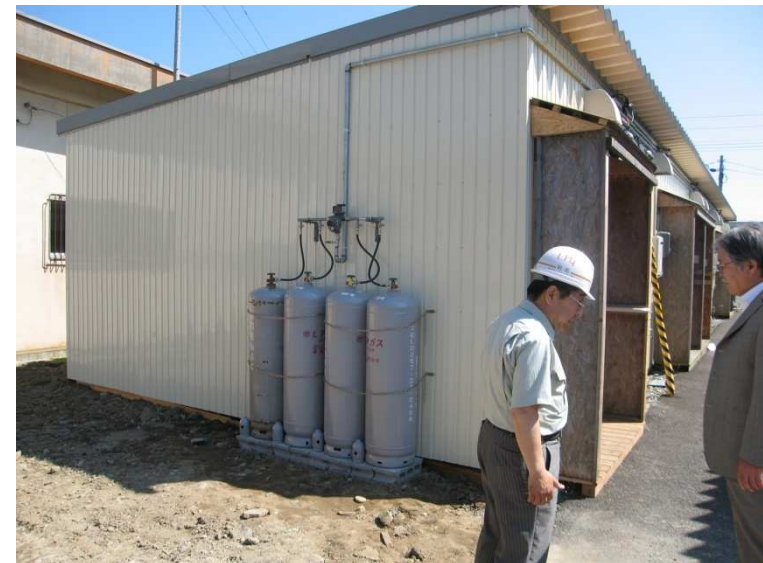
仮設住宅とLPガス
