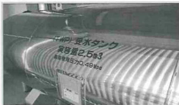
受水タンク(2.5m3) 4階
