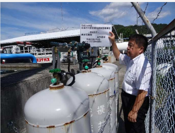
自家発電用LPGガス供給設備
