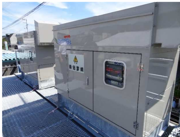
自家発電設備
