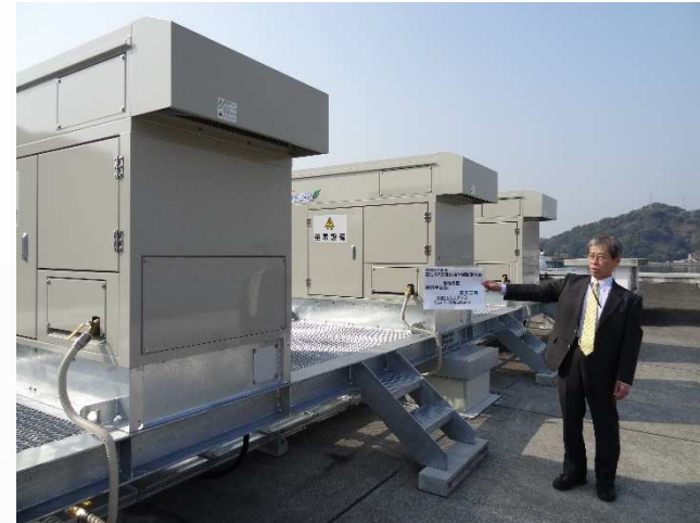
自家発電設備
