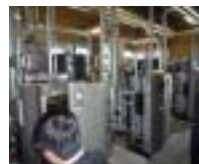
DME 使用ボイラー
