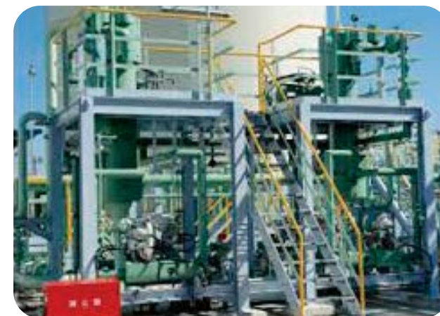
熱量調整装置(出典:九州ガス圧送 株)
