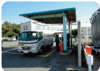
LPガス自動車充填設備
