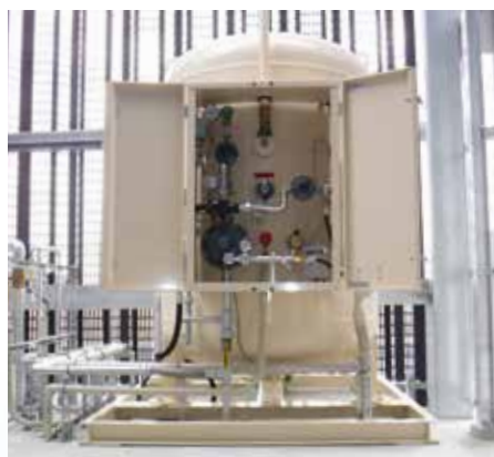
災害バルク貯槽
