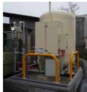
災害バルク貯槽
