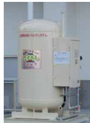
災害バルク貯槽
